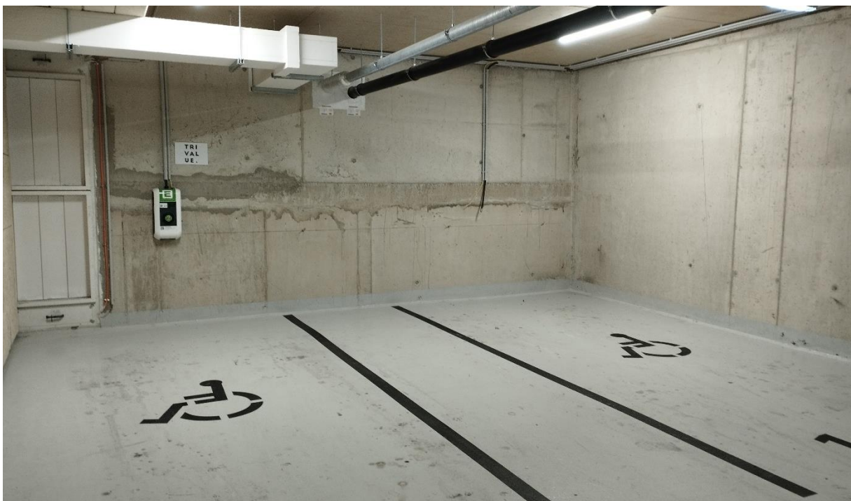
Abb. 40: Ladestationen E-Auto SC Nord (Smart Quadrat, WB-Str. 126-134)
